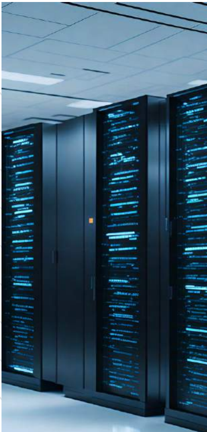
INTERNET DATA CENTER
